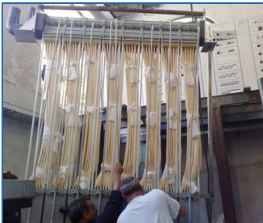
▲ Foto 2 - Installazione di moduli Siemens R40N a fibra cava nelle celle esterne al bioreattore di Occhiomarinao
